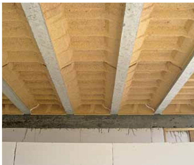
Obr. 7 Strop rodinného domu v Borskom Mikuláši – ako prvé sa položia krajné stropné vložky so stranou zapadajúcou do krycieho prvku. Ďalšie stropné vložky v rade sa ukladajú systémom pero a drážka s presahom od 1 cm do 6 cm
